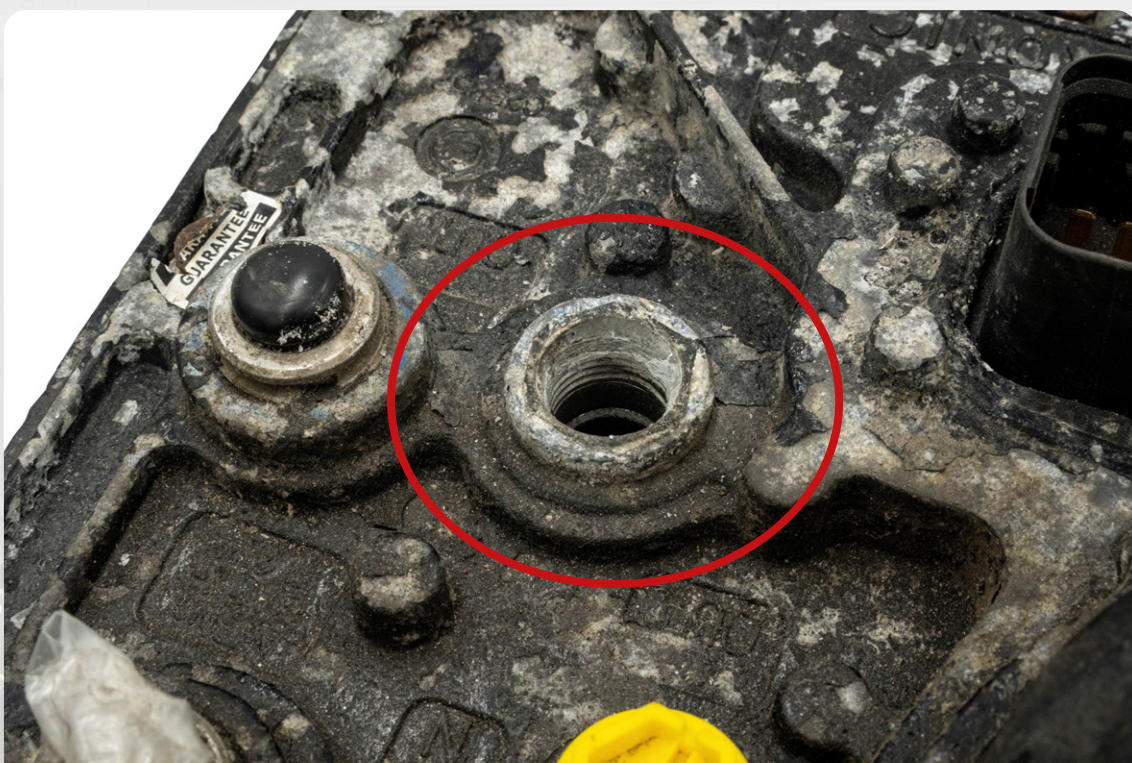
Uszkodzenia portów pneumatycznych
