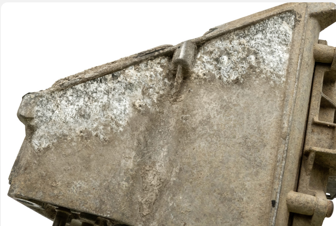
Uszkodzenia korpusu np. utlenienie
